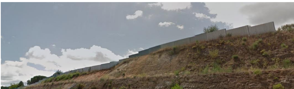
Imagem 3: Barreira de Blocos de alvenaria
